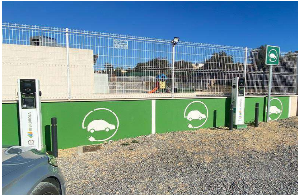
PUNTO DE RECARGA VEHÍCULOS ELÉCTRICOS
